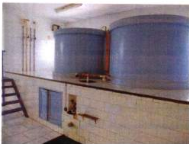
Figura 23 – Dosagens de Produtos Químicos
