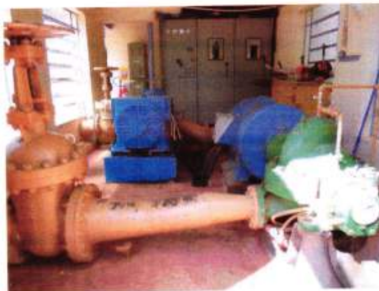
Figura 18 – Estação de Bombeamento de Água
